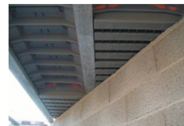
▲ 5-Pour une bonne étanchéité au coulage, l'appui des Tympan Biaï ne doit pas être inférieur à 5cm
